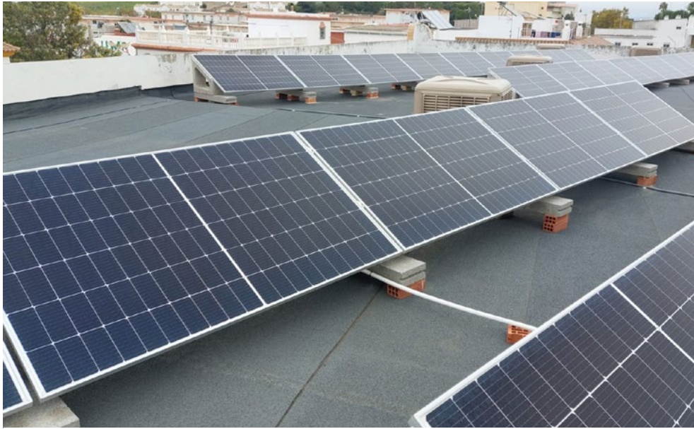
Instalación fotovoltaica del IES San Juan de Dios, Cádiz
