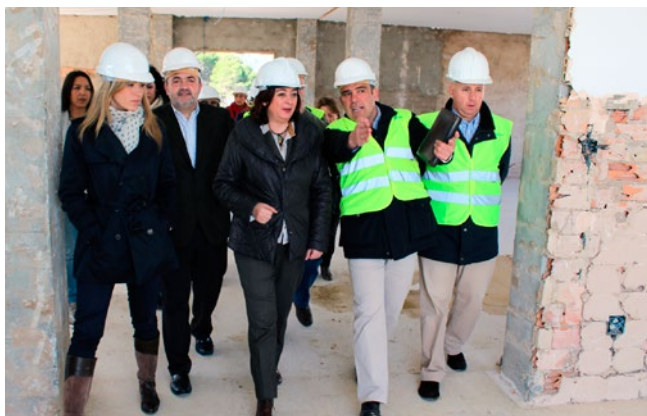
▼ Visita a la obra del Plan OLA de ampliación del Colegio Público Rural Mariana Pineda de Cerralba, en Pizarra (Málaga). Febrero de 2013.
